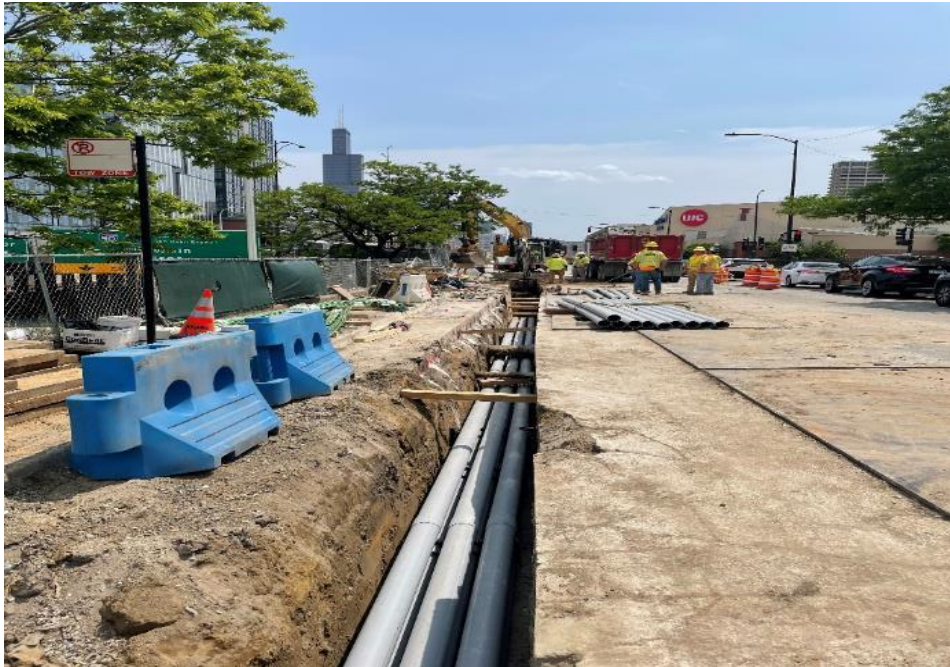
Racine Electrical Conduits
